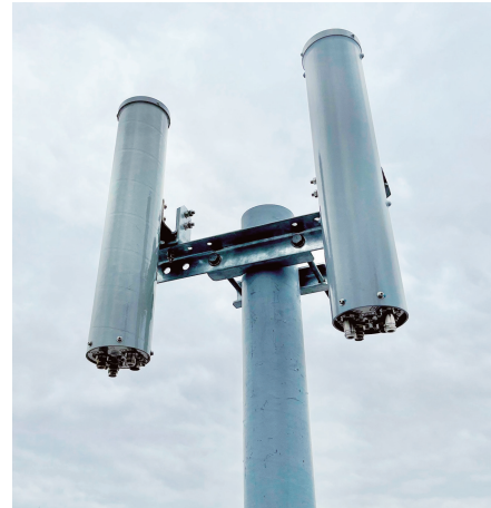
図4 アンテナ設置例
